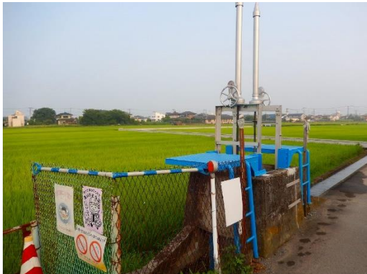
荒川からの灌漑用水分水施設
